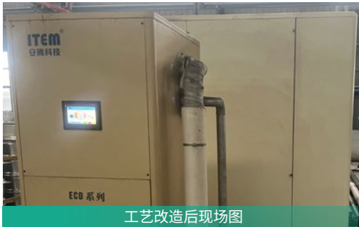
工艺改造后现场图
